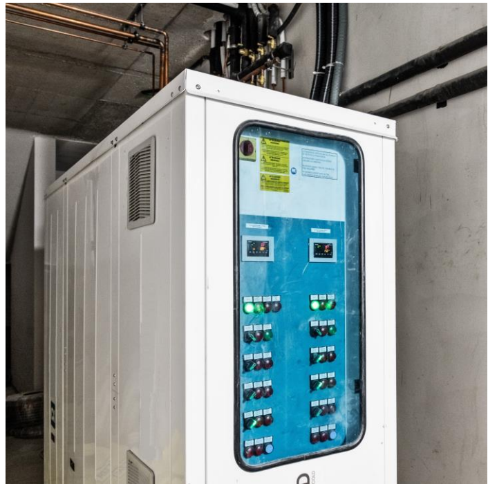
Abbildung 9 - Kühlzentrale Niederbacher Cool
